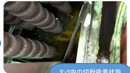
タンク内の切粉吸着状態
